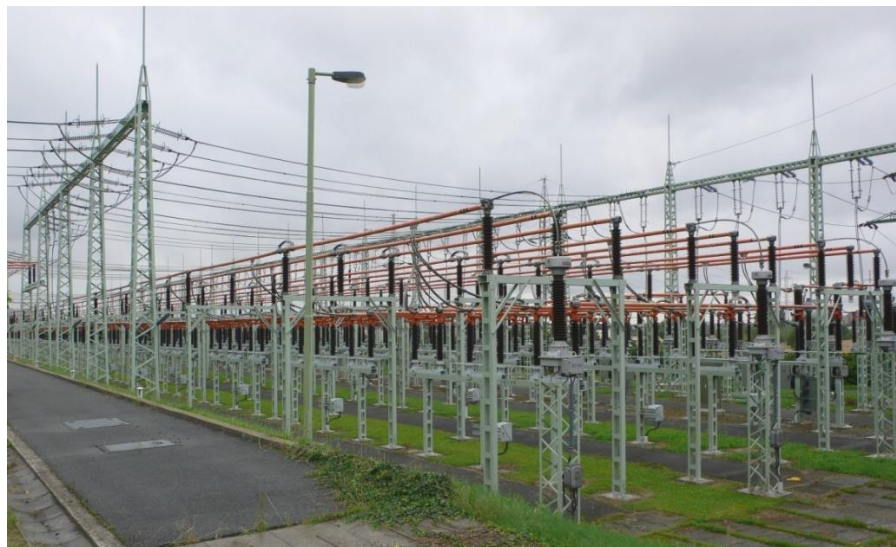
Obr. 2 Venkovní rozvodna 110 kV – TR Sever
