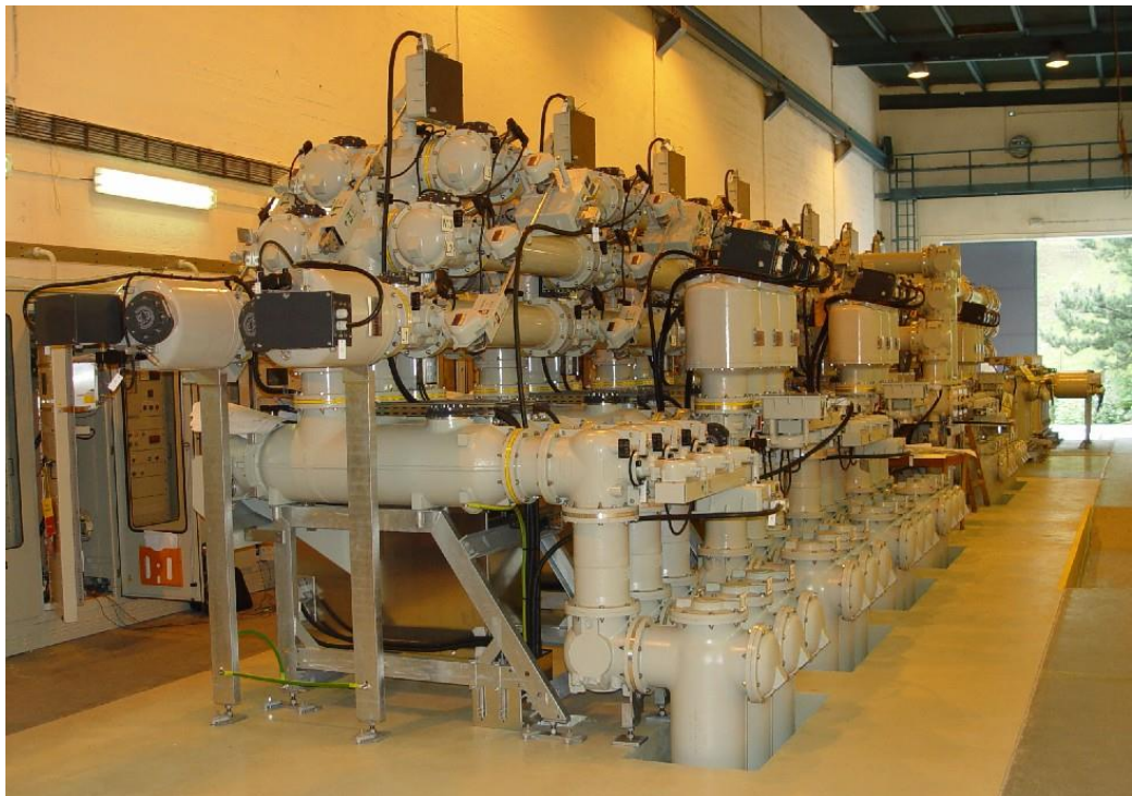
Obr. 3 Zapouzdřená rozvodna 110 kV – TR Střed
